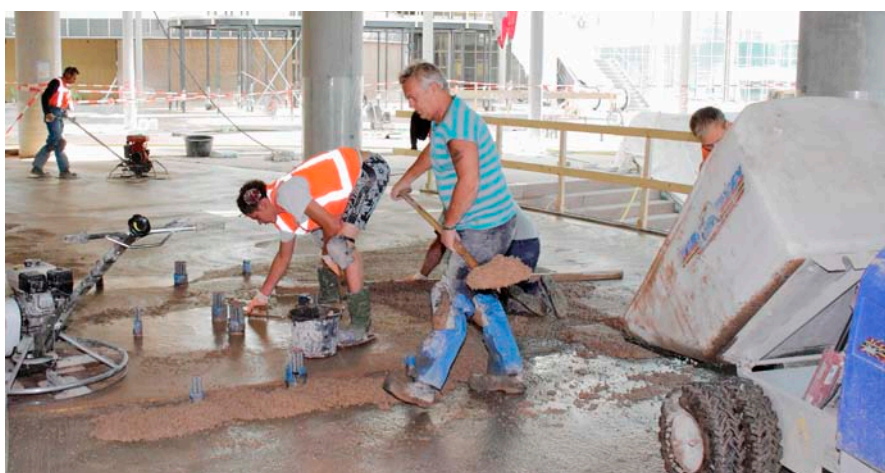
In 'De Verrekijker' moesten een heel aantal technische hobbels worden genomen om uiteindelijk tot de grootste aaneengesloten terrazzovloer te komen.
